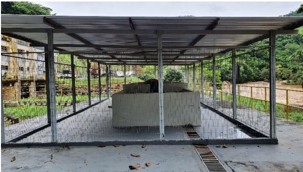
Caixa Separadora de Água e Óleo
