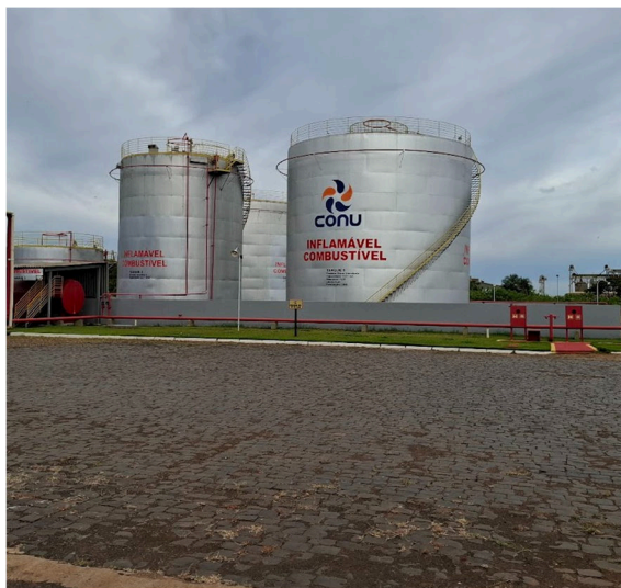
Tanques com bacias de contenção
