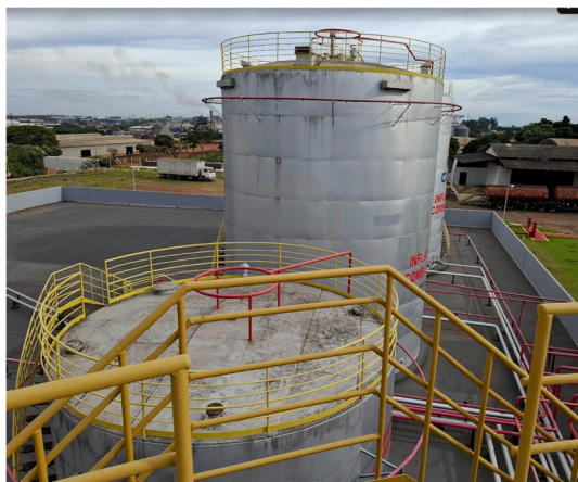
Tanques com válvulas de alívio de gases
