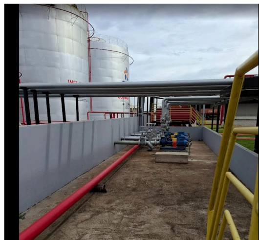
Conexões sobre bacia de contenção
