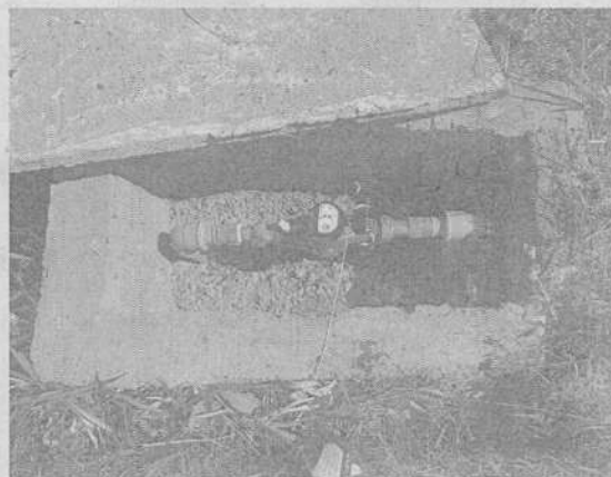
Foto 08. Hidrômetro do poço tubular
