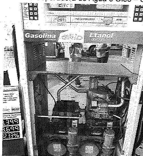
Foto 06: Bomba de abastecimento com check valve.
