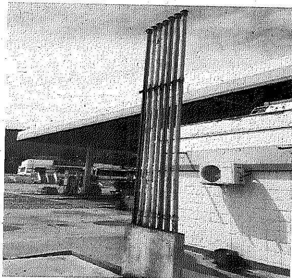
Foto 05: Respiros dos tanques.
