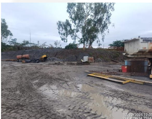
FOTO 3: Resíduos dispostos inadequadamente.
