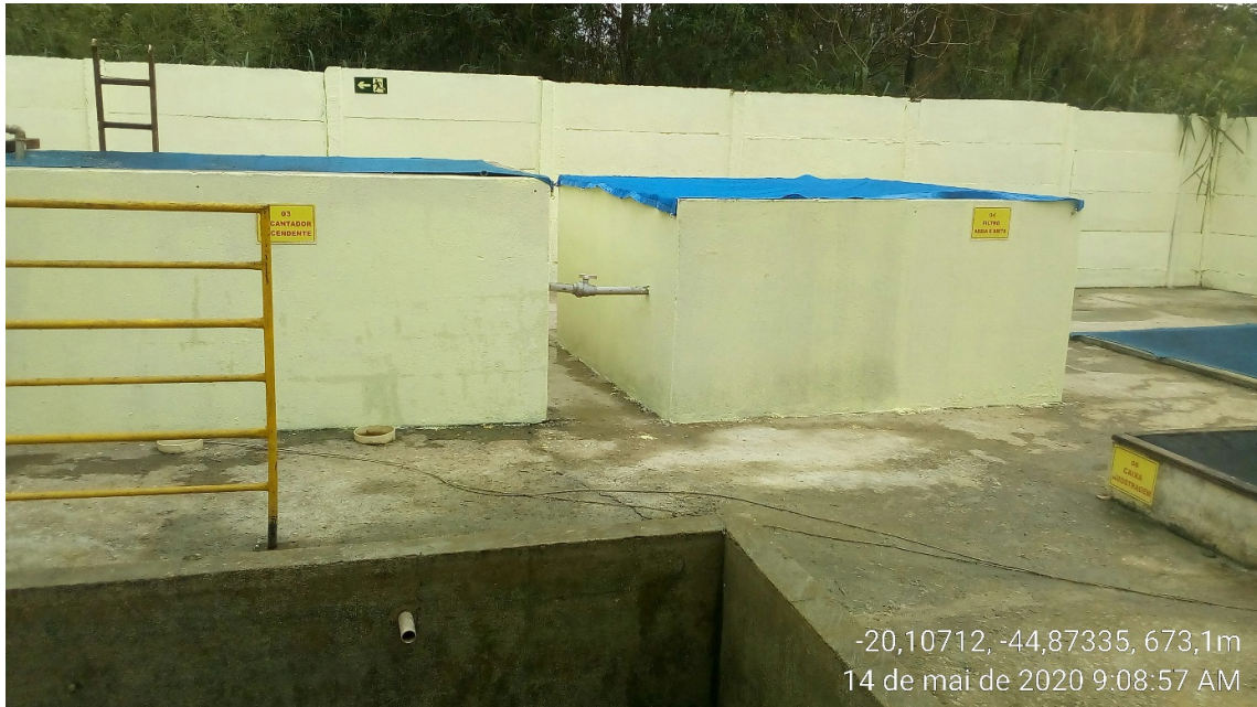
Foto 3 – Estação de Tratamento de Efluentes
