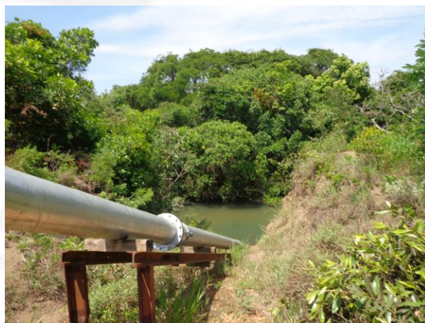
Figura 02. Ponto de captação de água
