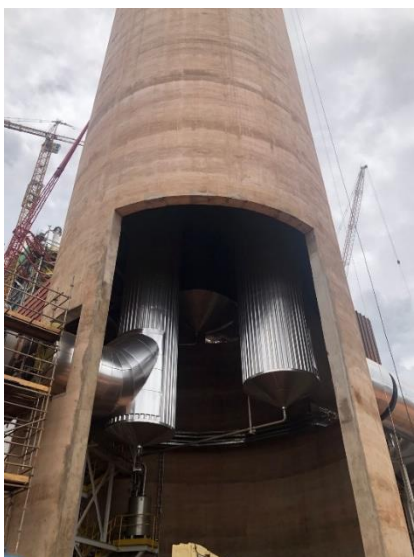
Figura 2-5 Saída unificada das chaminés
