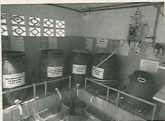
Foto 03. Armazenamento de produtos químicos para limpeza.
