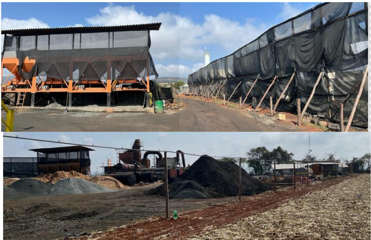
Figura 2 e 3 – Telas de proteção e sistema de umidificação de pilhas – Fonte: RAS
