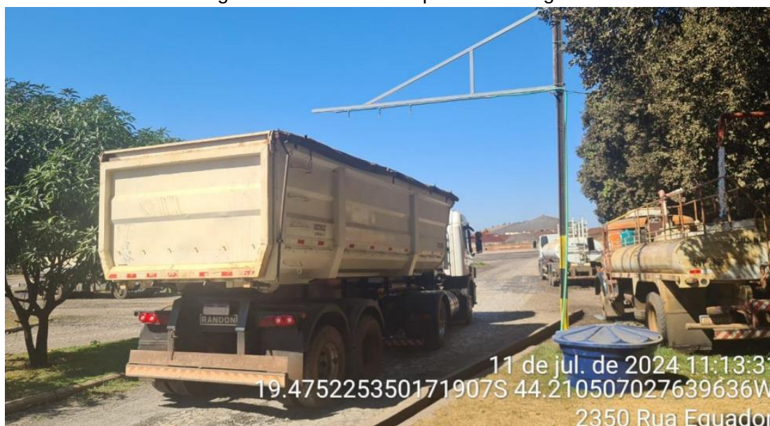
Figura 5.1.1. Sistema aspersor de cargas.
