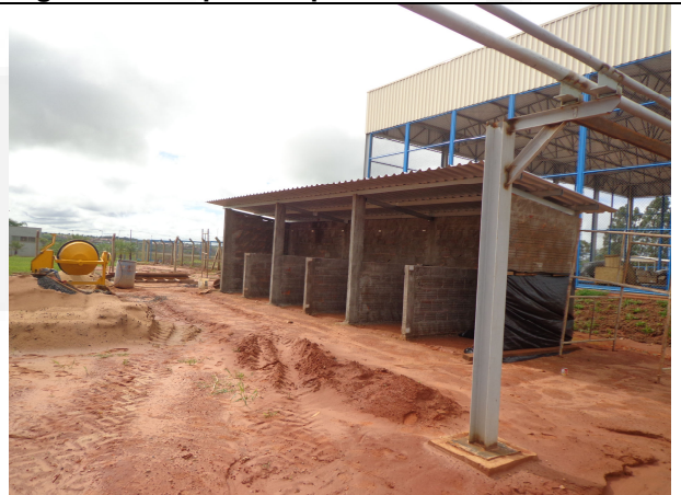
Figura 7- Unidade de armazenamento temporário de resíduos
