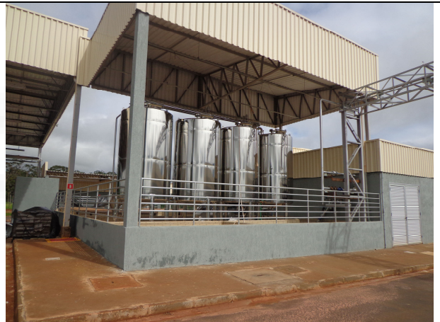
Figura 5- Tanques de produtos
