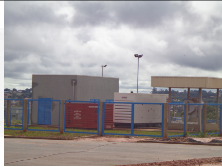
Figura 3- Gerador a Diesel
