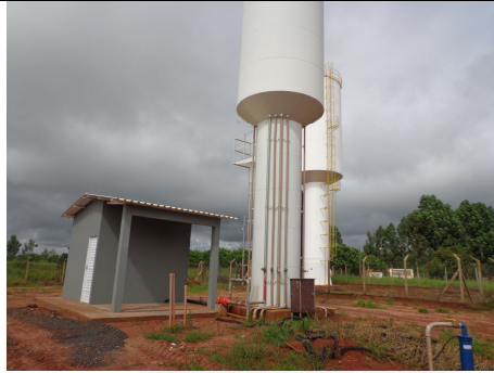
Figura 2- Poço artesiano utilizado no empreendimento
