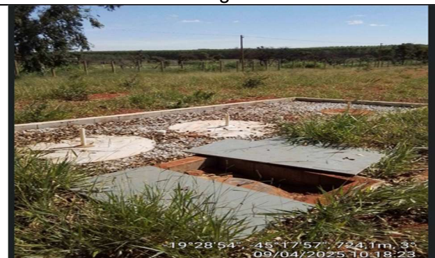
Foto 04. Sistema de Tratamento de Efluente Sanitários
