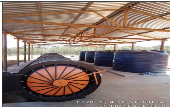
Foto 01. Galpão com autoclave e tanques
