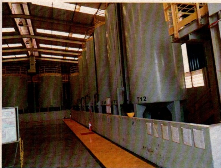
Foto da vistoria: Tanques verticais em local coberto, dotados de bacias de contenção
