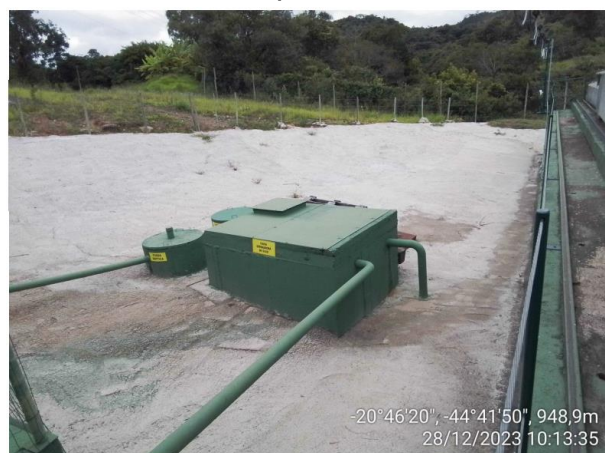
Foto 02. Sistema de tratamento de efluentes líquidos.
