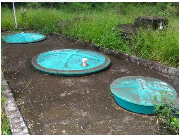
FOTO 3 – Fossa, filtro e sumidouro.
