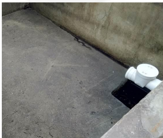
Foto 03. Tanque de armazenamento de sangue
