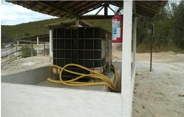
Foto 7. Tanque de abastecimento.
