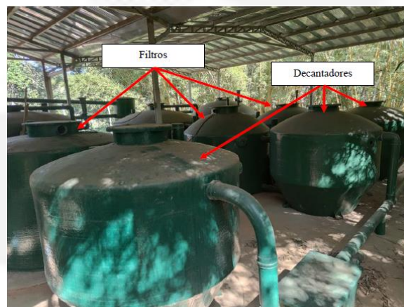
Foto 32: Filtros e decantadores
