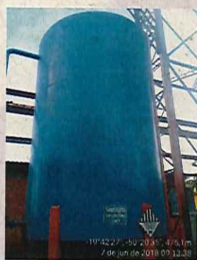
Figura 15- Tanque de armazenamento de óleo usado.
