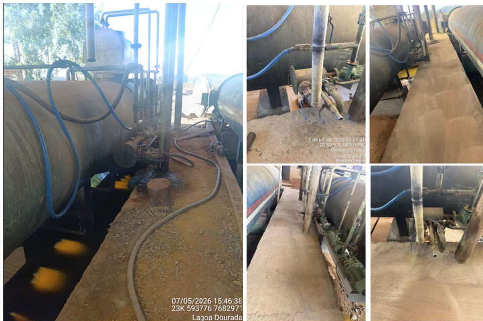
Foto 3 – Bacia de decantação das autoclaves, antes e pós melhorias realizadas.
