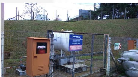
Foto 03. Armazenamento de gás para empilhadeiras.
