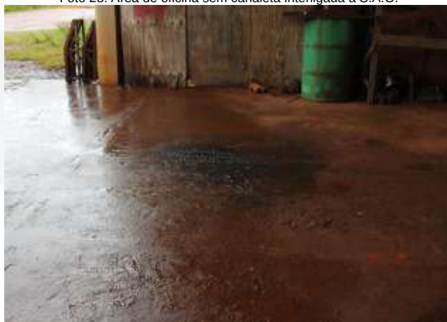
Foto 28: Área de oficina sem canaleta interligada a S.A.O.
