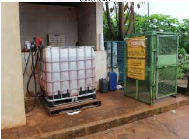
Foto 9: Local de armazenamento e abastecimento inadequado de combustível.
