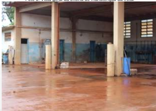
Foto 6: Vista geral da oficina de manutenção da frota.
