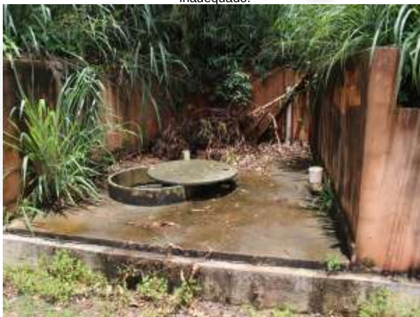
Foto 40: Sistema fossa séptica/filtro anaeróbio/sumidouro com funcionamento inadequado.
