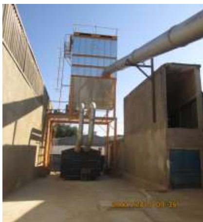
Figura 5: Sistema para recolhimento de pó de madeira (silo e container).
