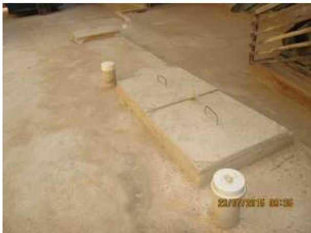
Figura 3: Fossa séptica instalada no primeiro galpão da empresa.
