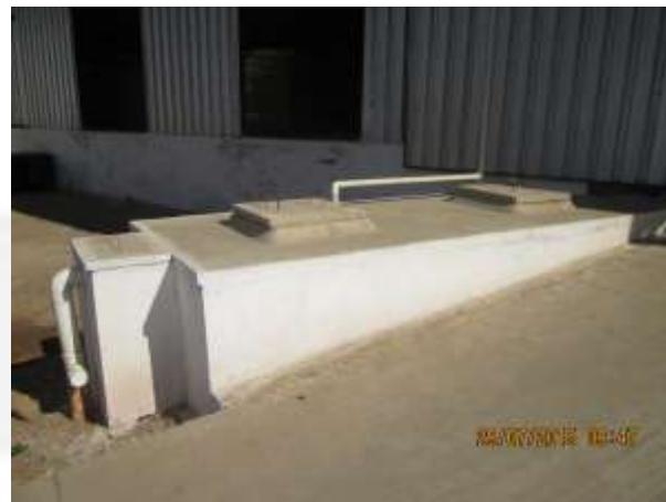
Figura 4: Fossa séptica instalada no galpão dos fundos do empreendimento.
