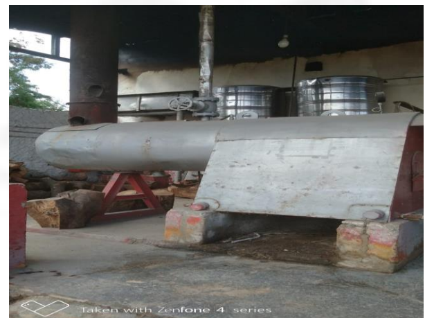
Foto 04. Caldeira à lenha
