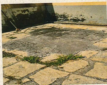
Figura 6: Fossa séptica atual.
