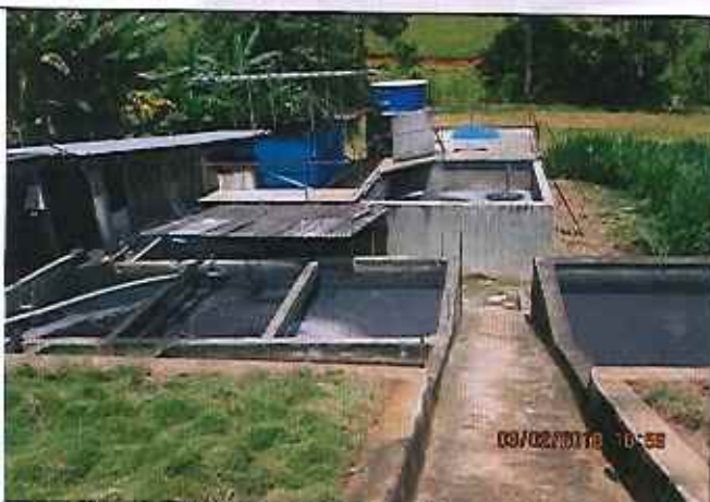
Foto 7: planta de tratamento de efluente bruto
