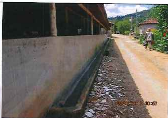
Foto 6: canaleta de efluente gerado na suinocultura com calha protetora de água pluvial
