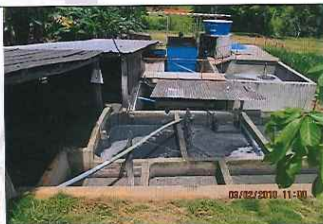
Foto 14: tanque de equalização, célula flotação, filtro biológico e leito de secagem
