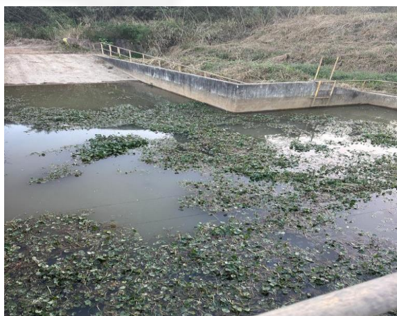
Foto 7 – Bacia de decantação / ETA
