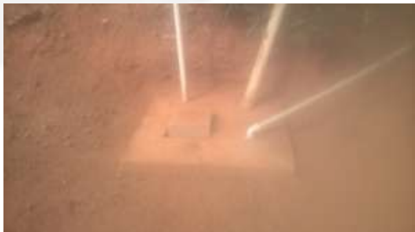
Foto 06: Sistema de Fossa Séptica.
