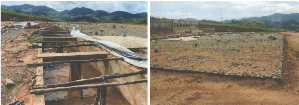
Figura 4 - À direita, fosso em construção, sobre o qual será alocada a autoclave. À esquerda, vista do platô de produção, com área de manobra calçada. Fonte: RCA.
