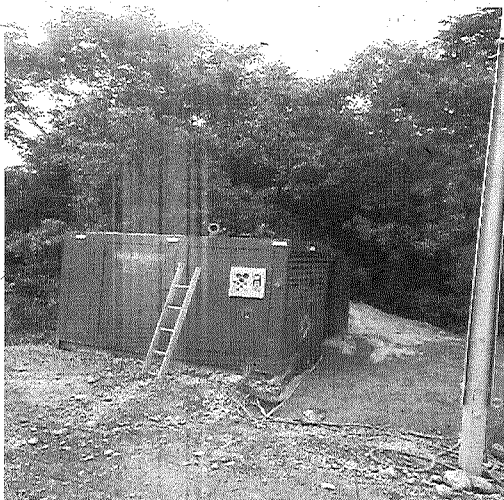
Foto 09. Gerador de energia
