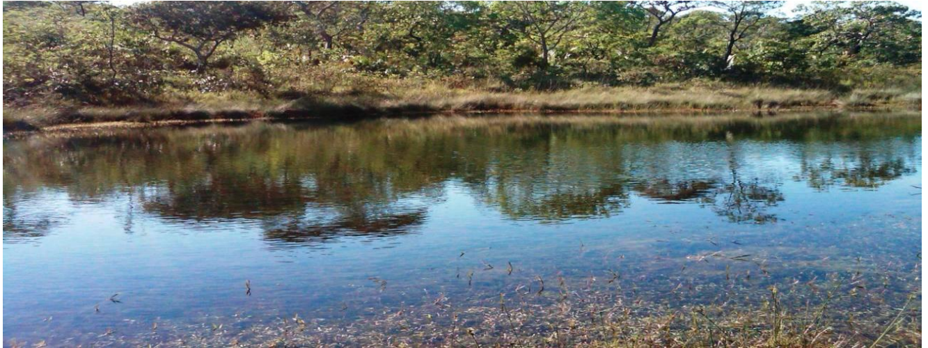
Figura 06 -Barramento rompido existente no Ribeirão do Corrente
