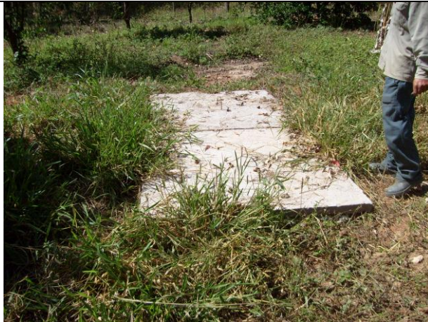
Fossa Séptica– Bloco 2
