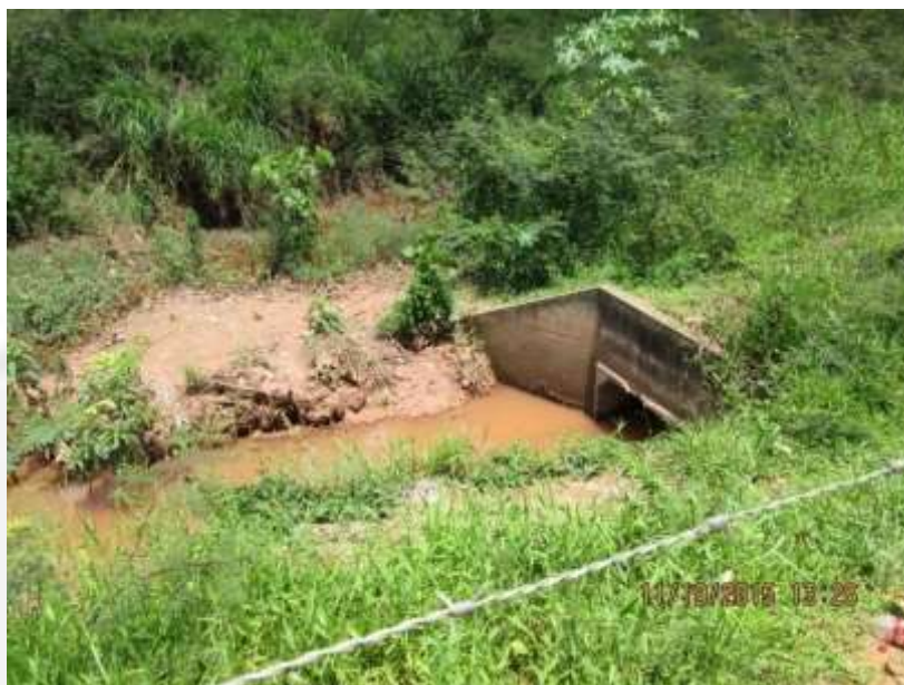
Córrego Teixeira (final canalização já existente) no local de início da intervenção
