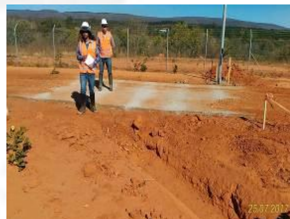
Foto 08. Caixas passagem sistema de drenagem
