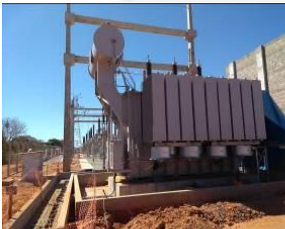
Foto 01. Subestação de energia elétrica
