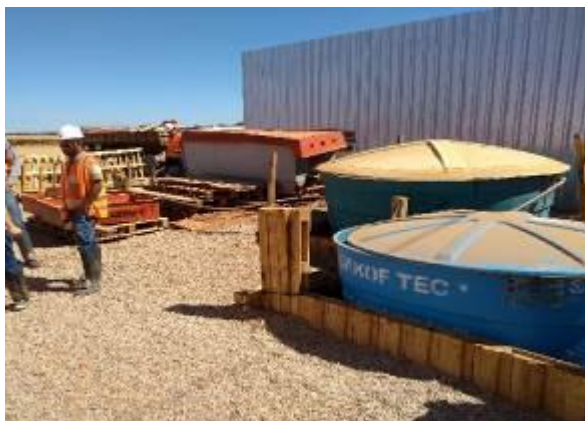
Foto 05. Sistema prévio de tratamento de efluentes (eletrolítico)
