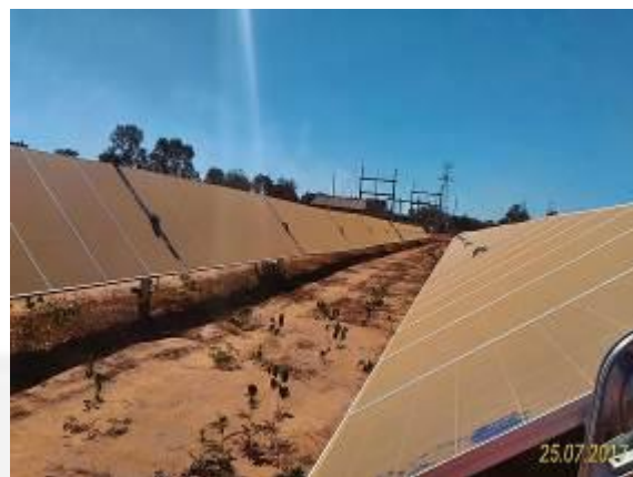
Foto 06. Painéis solares instalados
