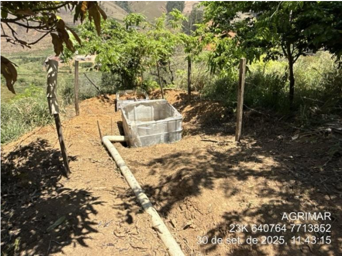
Foto 2. Vista do sistema de tratamento dos efluentes advindos da moagem.
