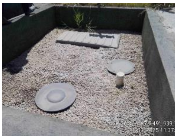
Foto 05. Caixa separadora água/óleo.
