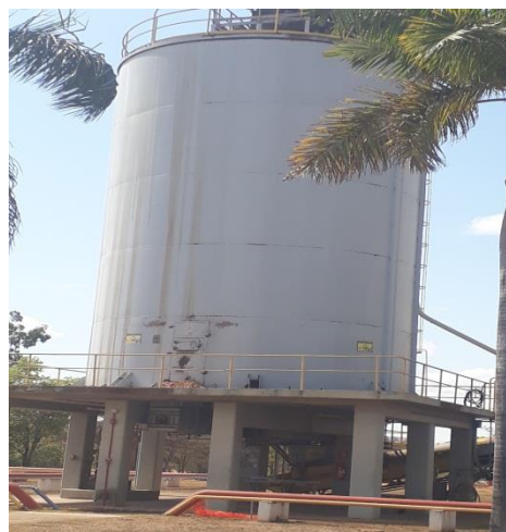
Foto 2 – Silo armazenamento cavaco para caldeira
