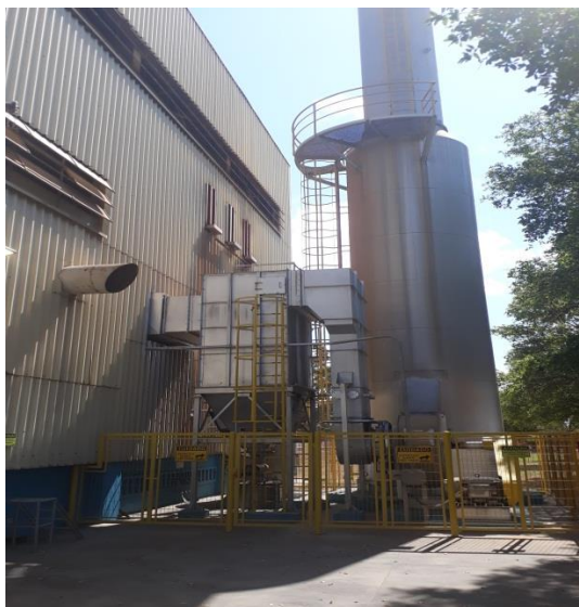
Foto 3 – Sistema multiciclone e chaminé da caldeira
