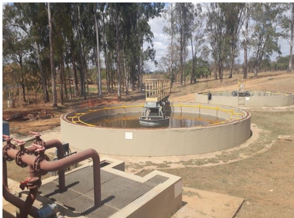
Foto 9 – Decantadores da PTAR
