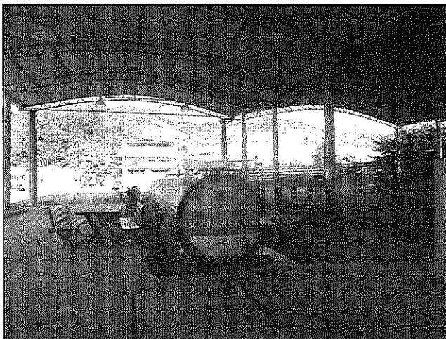
Foto 03 – Vista da autoclave utilizada para tratamento de madeira.
