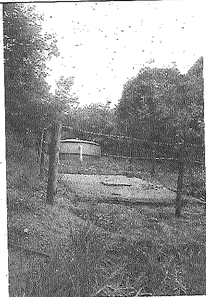
Foto 3: Sistema de tratamento de efluentes líquidos sanitários.
