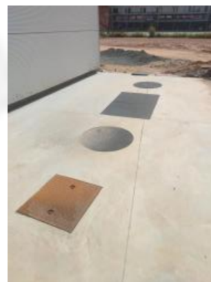
Foto 8: Caixa separadora de água e óleo.
