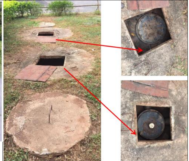
Foto 08. Sistema de fossa séptica
