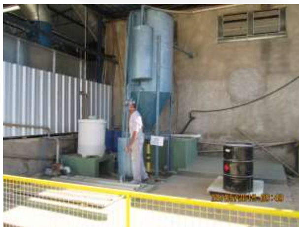
Foto 03. Estação de Tratamento de Efluentes Industriais
