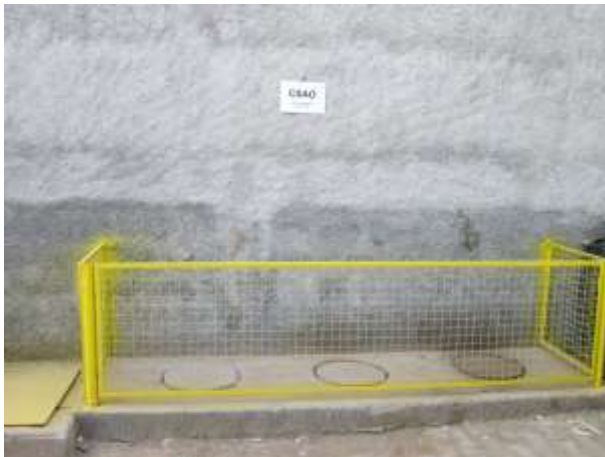
Foto 05. Caixa SAO unidade Matriz
