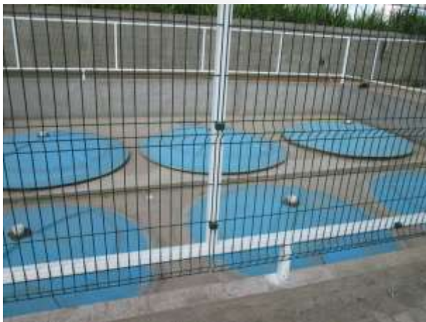
Foto 09. Sistemas fossa séptica/filtro anaeróbio
