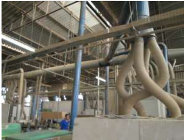
Foto 01. Sistema de exaustores para o pó de madeira
