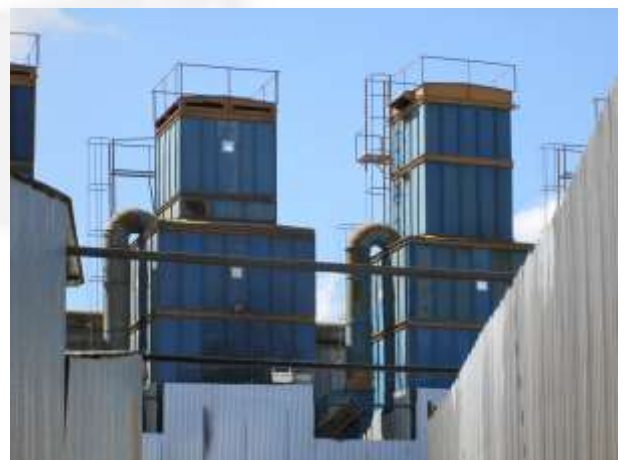
Foto 04. Silos para armazenamento de pó de madeira
