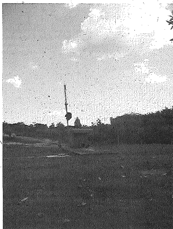
Foto 04. Dispositivo para queimar os gases gerados no tratamento dos efluentes sanitários.
