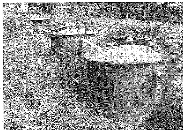
Foto 8: Sistema de tratamento de efluente líquido sanitário.
