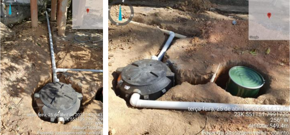
Fotos 2 e 3. Sistema de tratamento dos efluentes sanitários (Fossa Séptica).
