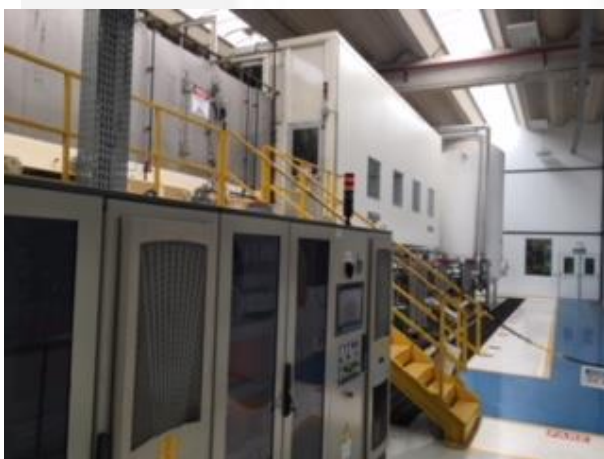
Foto 03. Novo setor de pintura KTL.
