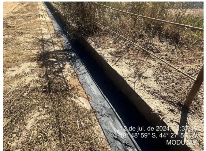
Foto 24: Canaletas de drenagem que advém da área do galpão de carvão
