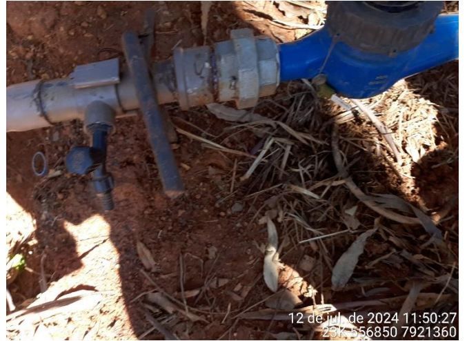
Foto 104: Torneira de monitoramento do poço 03.
