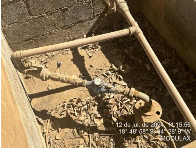
Foto 109: Poço artesiano próximo ao estacionamento de caminhões, com entrada da medição de nível sem tampa.
