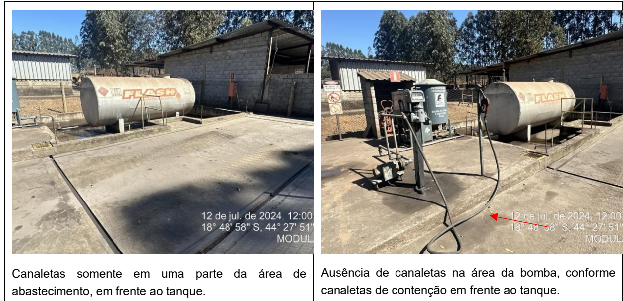
Figura 6. Ponto de abastecimento em operação.
