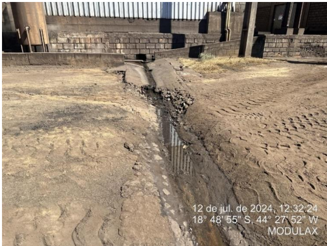
Foto 27: Canaleta com avaria próximo à termelétrica.
