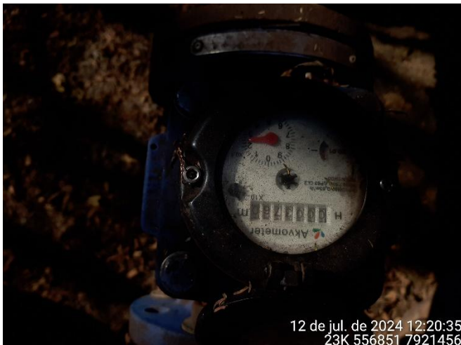
Foto 95: Hidrômetro do poço 01.
