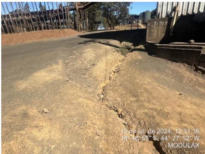
Foto 29: Início de erosão
