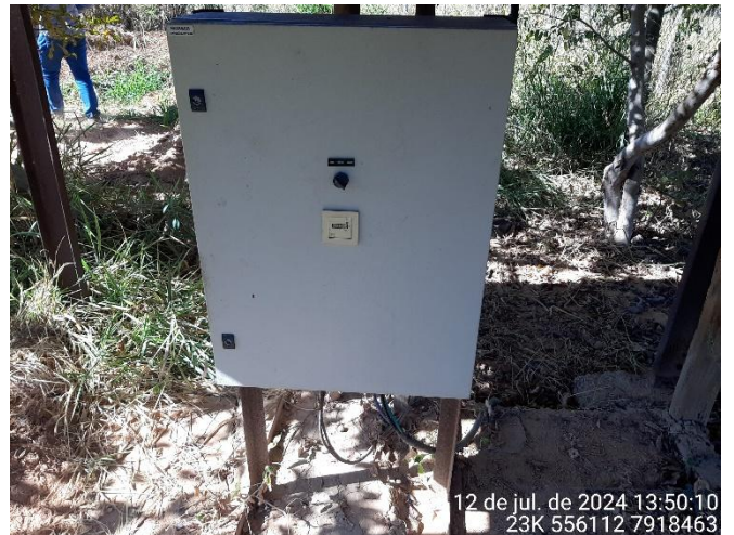
Foto 102: Horímetro do poço 02.
