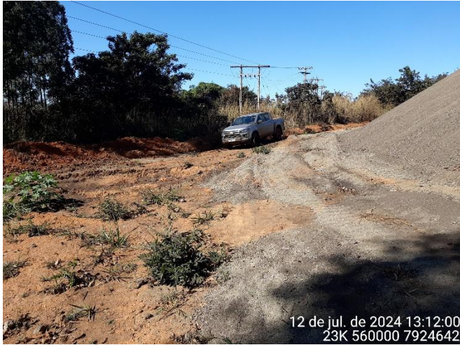
Foto 79: Forma de direcionamento de água pluvial construído no entorno da pilha.
