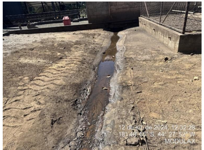
Foto 28: Canaleta com avaria próxima à termelétrica
