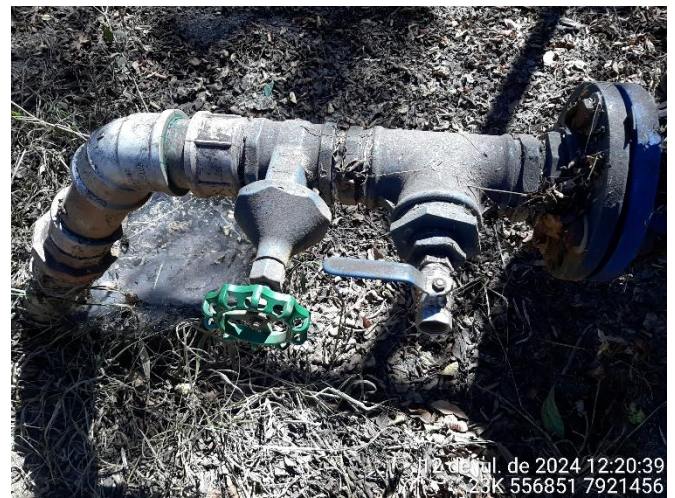
Foto 94: Torneira de monitoramento do poço 01.
