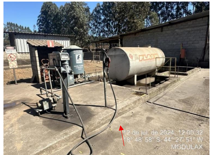
Foto 70: Posto de combustível em operação, com área de bombas sem contenção e/ou canaletas. A canaleta existente não abrange toda área, demandando obras de correção.
