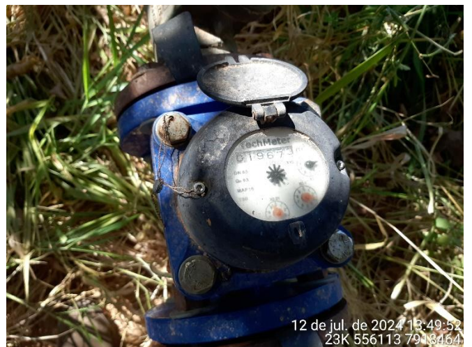
Foto 100: Hidrômetro do poço 02.
