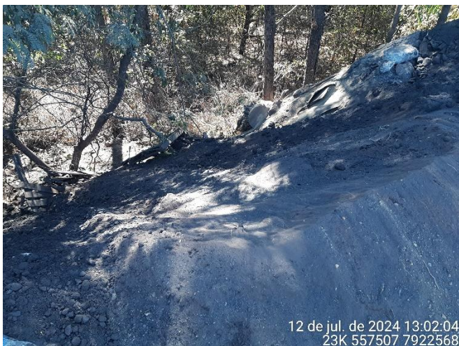
Foto 113: Resíduos depositados de forma incorreta com supressão de vegetação e aterramento parcial de algumas árvores.
