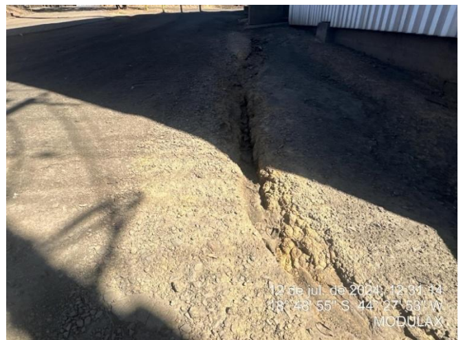
Foto 30: Início de erosão.
