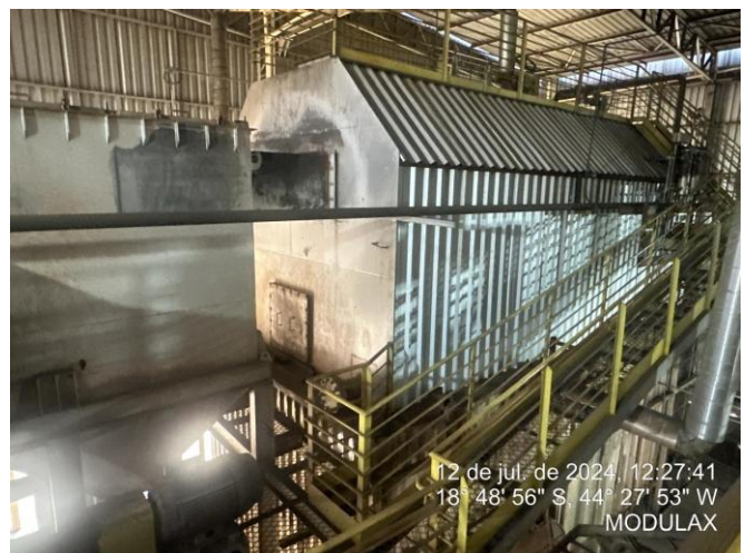
Foto 36: Termelétrica vista por dentro. Ao fundo, estrutura da caldeira, enclausurada
