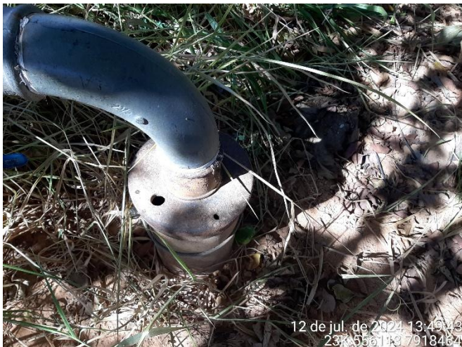
Foto 101: Tubo de monitoramento estático do poço 02. Durante a vistoria estava aberto.
