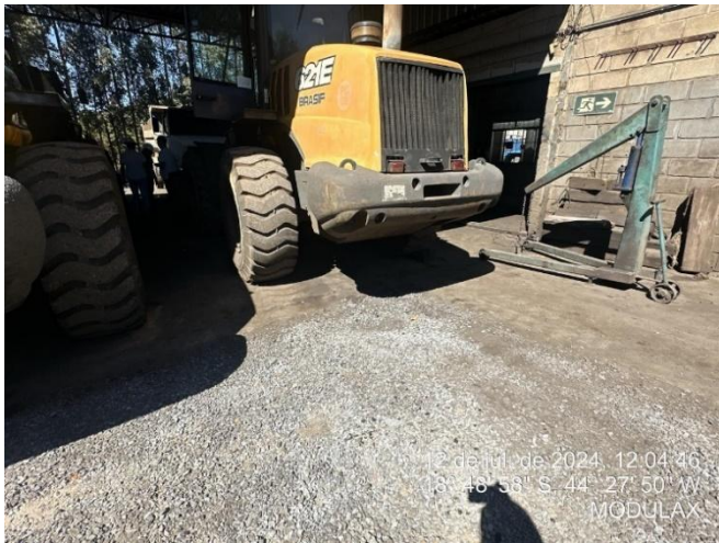
Foto 63: Oficina mecânica – piso não impermeabilizado e ausência de canaleta de drenagem.
