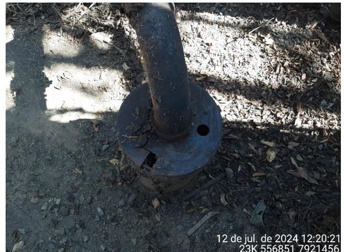
Foto 96: Tubo de monitoramento estático do poço 01. Durante a vistoria estava aberto.
