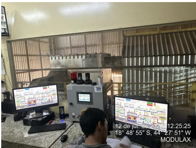
Foto 35: Painel de controle da termelétrica
