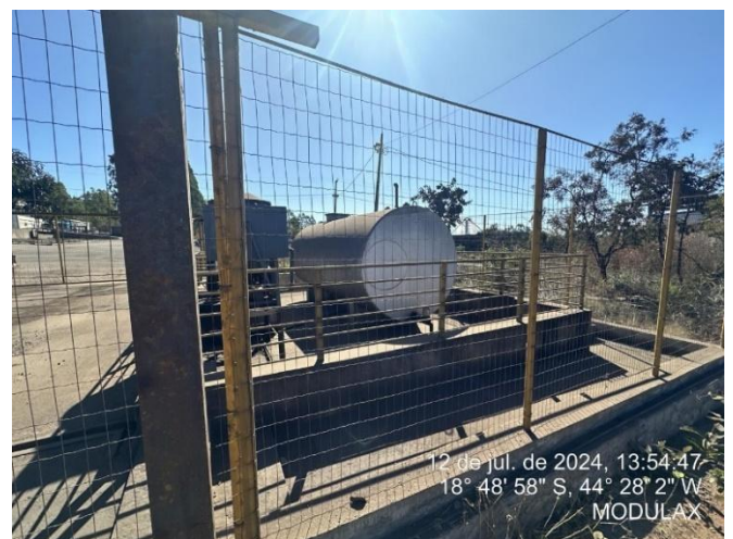
Foto 72: Tanque que contempla o posto de combustível desativado.
