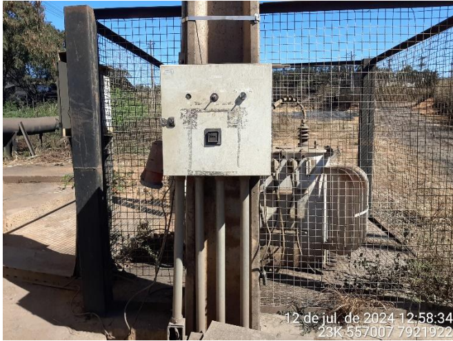
Foto 97: Horímetro do poço 01.
