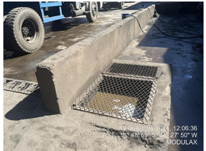
Foto 68: Área do lavador de veículos, com caixas para os sedimentos advindos da lavagem decantarem antes dos efluentes seguirem para a CSAO.
