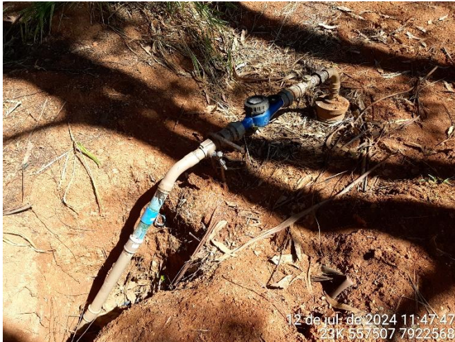
Foto 103: Hidrômetro do poço 03.
