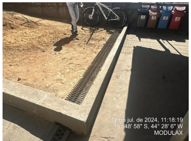
Foto 22: Canaletas de drenagem localizadas na portaria
