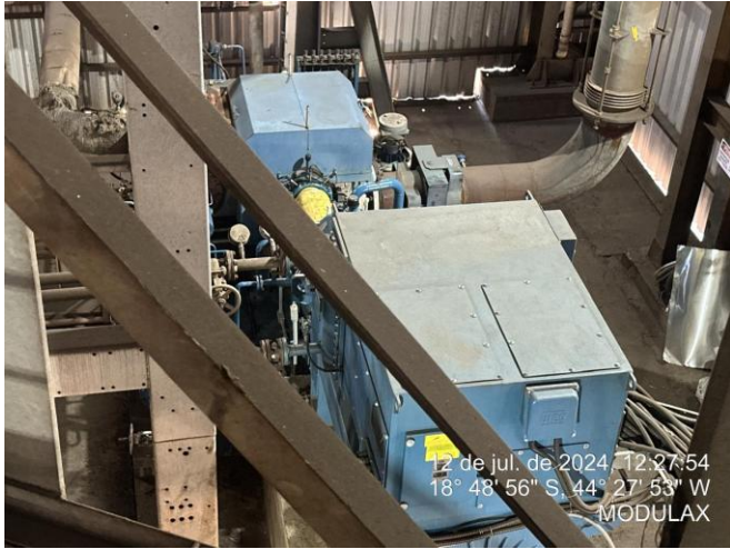
Foto 37: Transformadores que compõem sistema da termelétrica
