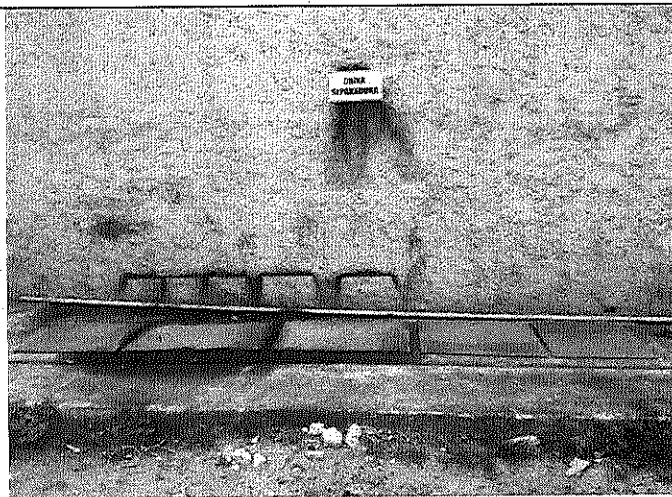
Foto 06 – Caixa separadora de água e óleo
