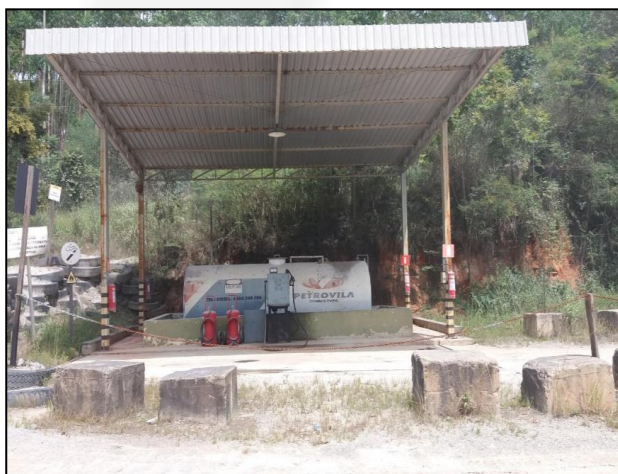
Foto 07 – Ponto de abastecimento do empreendimento (BELMONT - 2019). Observa-se que o tanque de diesel, com capacidade de 15 m 3 , encontra-se em local coberto e com bacia de contenção em alvenaria. Registra-se ainda que a pista de abastecimento é impermeabilizada, possuindo sistema de canaleta conectado à caixa SAO.
