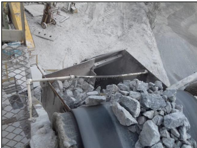
Foto 05 – Sistema de aspersão de água na unidade de britagem para controle de material particulado (BELMONT - 2019).
