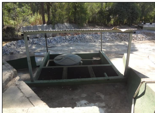
Foto 08 – Caixa desarenadora/Caixa SAO do empreendimento (VISTORIA SUPRAM/LM - 04/09/2019).
