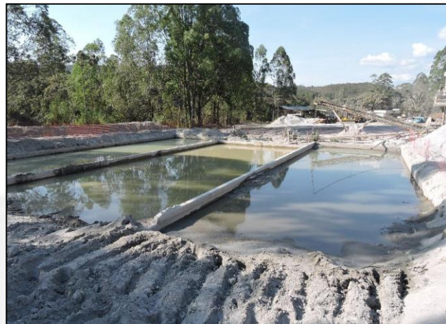
Foto 06 – Bacias de decantação construídas em concreto armado para onde é destinado o efluente industrial (BELMONT - 2019). Após a secagem, o material sólido é destinado a comercialização (super-fino), utilizado para reboco de parede e argamassa.
