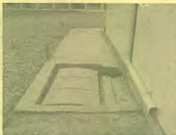
Foto 04. Caixa SÃO da área de lavagem de veículos
